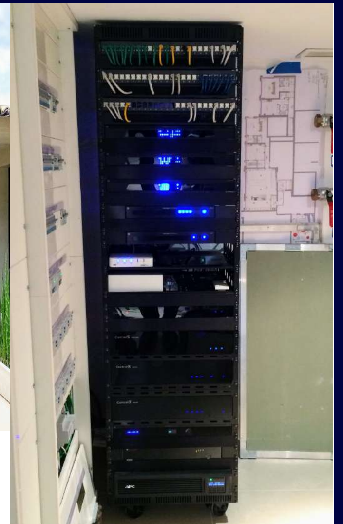
Baie informatique Multiroom audio Domotique KNX Réseau informatique Réseau antennes Distribution vidéo
