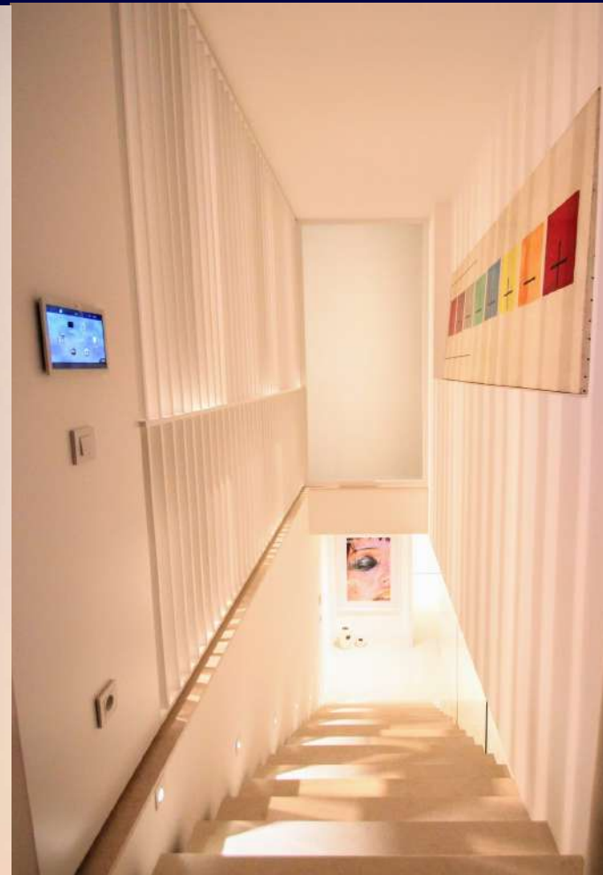
Pilotage intégral de la maison sur dalle tactile et autres appareils connectés
